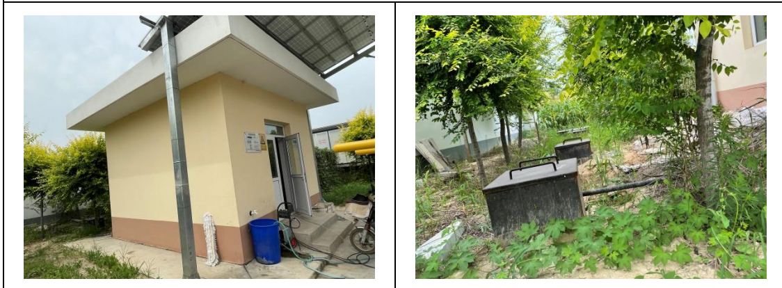
高阳北收费站污水处理设施
